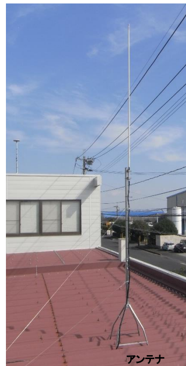
図-7 補正情報送信アンテナ設置状況
