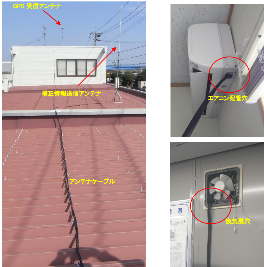
図-8 アンテナケーブル配線状況
